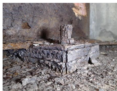
支承に腐食が見られます
