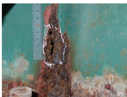
主桁に腐食が見られます
