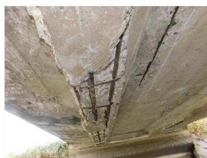
主桁に剥離・鉄筋露出が見られます
