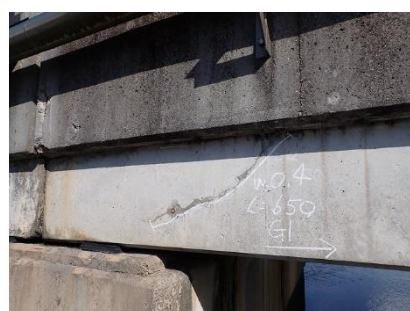
主桁にひびわれが見られます
