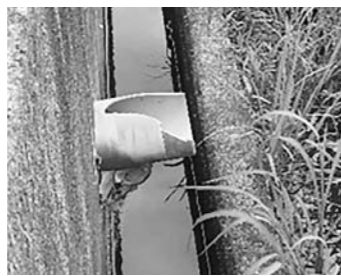
キャップが破損している例
